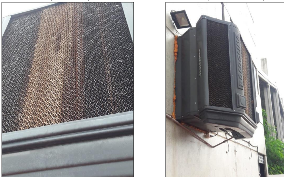
Figura 3. Sistema de ventilação do empreendimento com os filtros completamente empoeirados.
