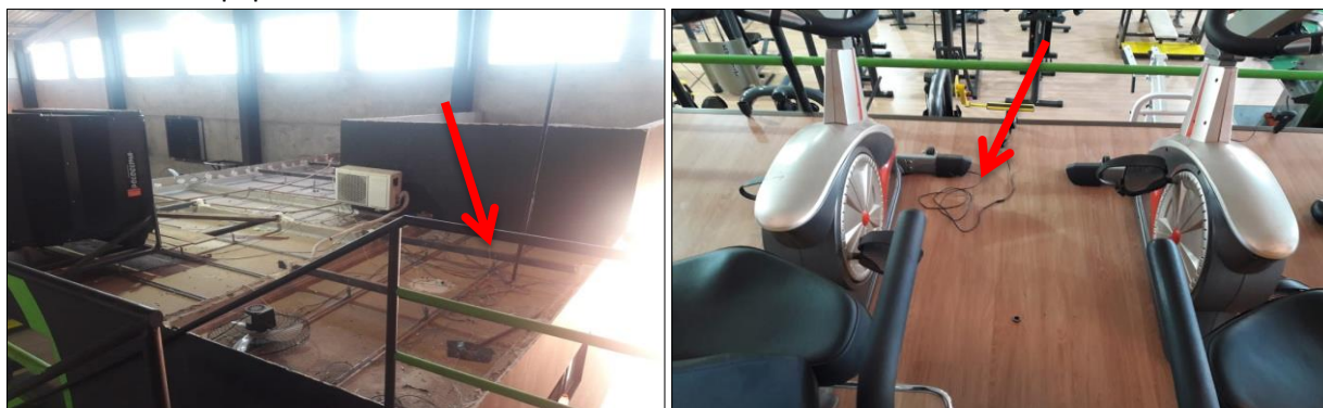
Figura 4. Vista dos fios de eletricidade desorganizados sobre a laje do vestiário e desencapados e remendados dos equipamentos de atividades físicas.
