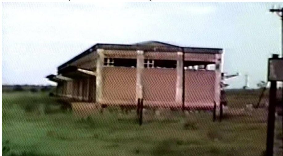
Figura 6. Armazém desativado e em processo de deterioração - 1992
