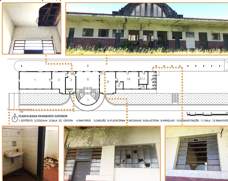
Figura 5. Patologias sala de espera, plataforma e exterior
